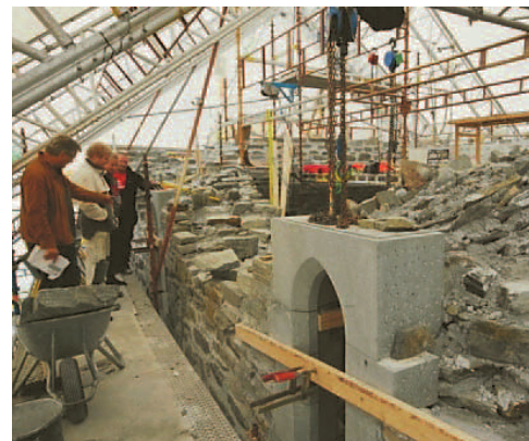
Inspeksjon av murerarbeidet. Bortsett fra en elektrisk blandemaskin og heis på utsiden av bygget, er murenes verktøy og arbeidsmetoder temmelig likt som i middelalderen. Fra venstre: Daglig leder ved Utstein Kloster, Jørg Eirik Waula inspiserer murerarbeidet sammen med sivilarkitekt Siri Refsland Tønnessen. Foto: Helge Schjelderup.
